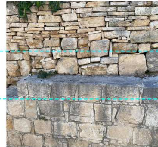
Εδώ φανεται η μετέπειτα επεμβαση σε τοιχοποιες στο χωριο
