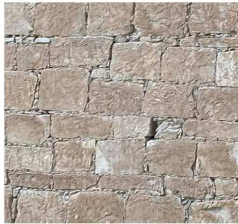
Τοιχοποιία με χρήση ίδιου μεγέθους λίθων με τη χρήση χαλικώματος για αρμούς
